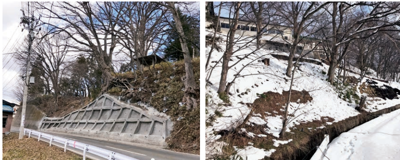
施工後全景(左：平成29年度施工直後、右：令和3年度施工後1年半)
