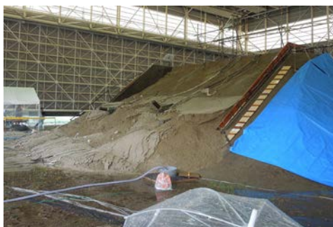
写真 2-2 斜面崩壊状況
