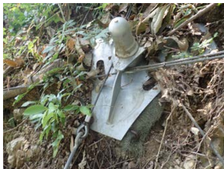
No.3 尾道市栗原町 (上: 全景、下: 支圧板洗堀状況)
